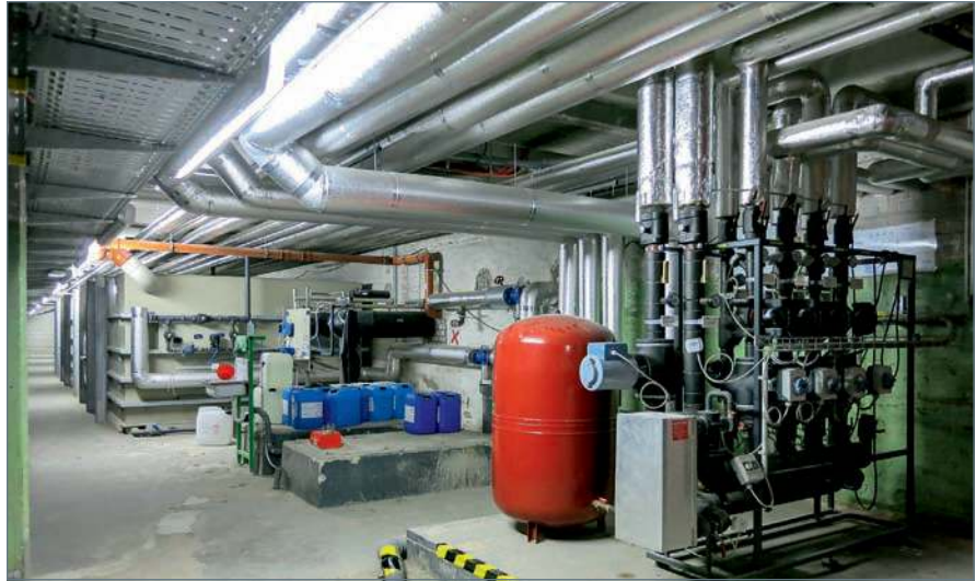
■ Schwallwasserbehälter mit Wasseranalyse; Foto: Tobias Reckert, Berlin
