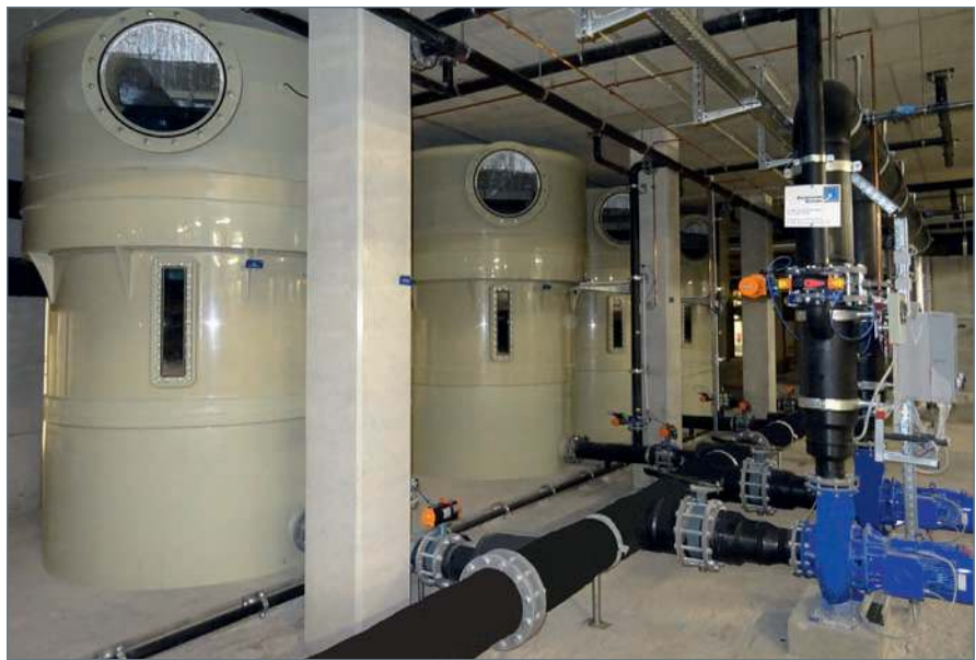
■ Unterdruckfilter in energieoptimierter Ausführung; Foto: Jürgen Elgg, Wassertechnik Wertheim
